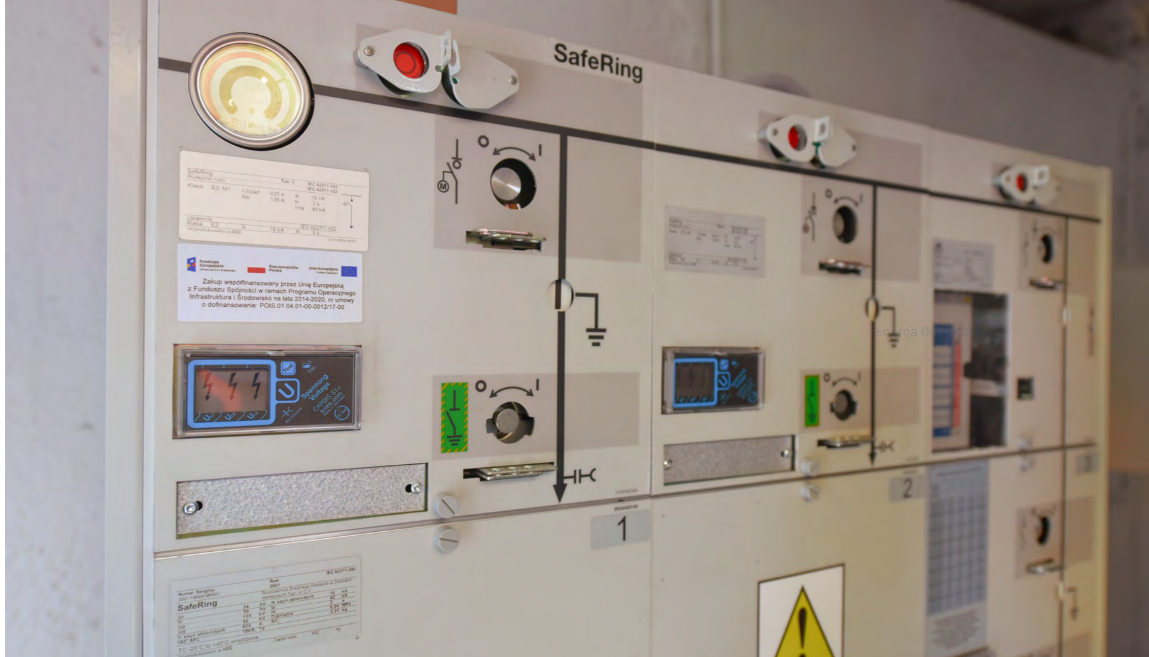
Energia-Operator, Rozdzielnica wewnętrzna zdalnie sterowana
